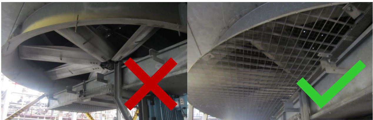
Abb. 1: Lüfterflügel eines Wärmeübertragers – links: nicht MRL-konform (ohne Eingreifschutz), rechts: MRL-konform (mit Eingreifschutz) Quelle: BASF (im Rahmen einer MRL-Prüfung durch planting)
